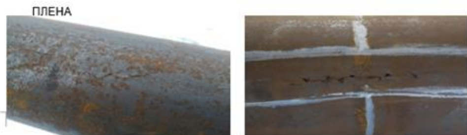
Рисунок 2 - Дефекты на внешней поверхности трубы
