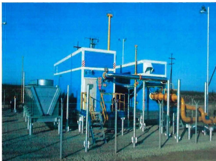
Рис.1. Внешний вид узла захлаживания
