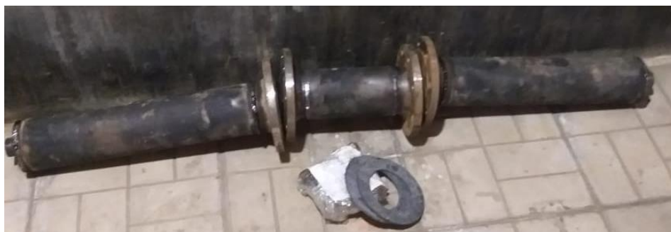
Рис. 2 Участок выкидной линии трубопровода
